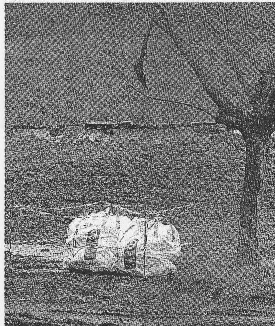
I sacchi pieni di amianto ancora nel cantiere
